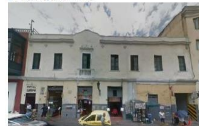
Figura 4: Estado actual de fachada (Fuente: Prolima, Junio 2019)
